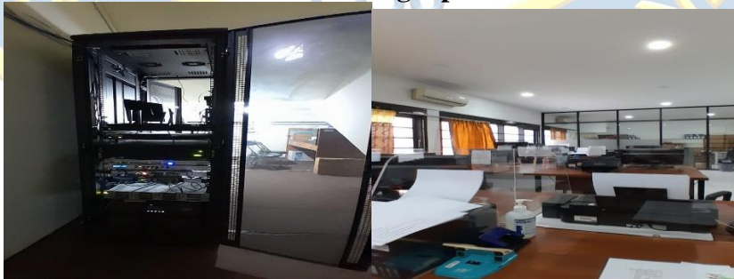
Gambar 2. Hardware Server dan Kelengkapan Fasilitas Kantor
